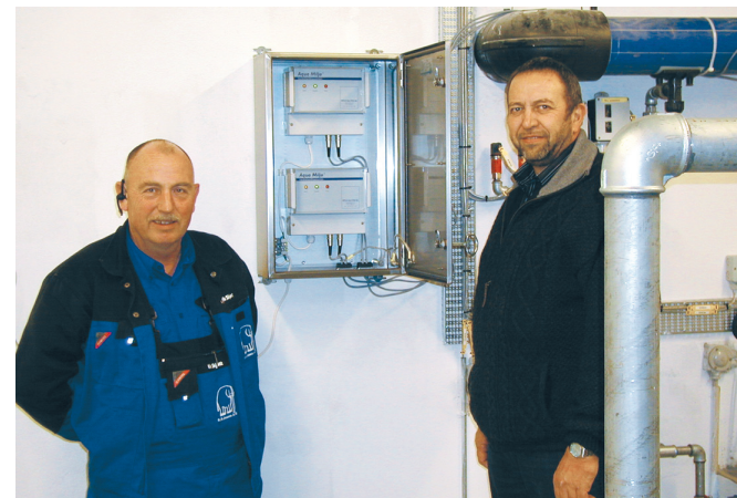
Formand Erik Skjøtt og Kasserer Erik Jensen ved det nye vandbehandlingsanlæg.
